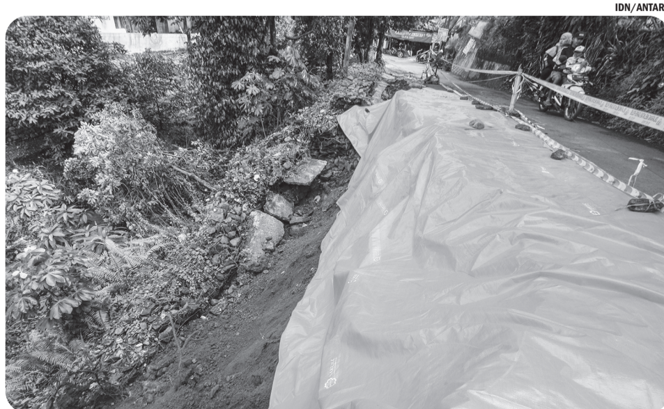
JALAN LONGSOR DI BOGOR
